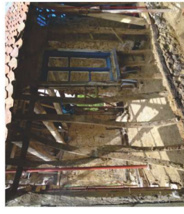
État de l'ossature bois après avoir retiré le torchis en mai 2016.
